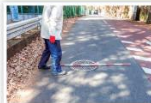
下水道施設の緊急点検 (マンホール周囲の段差や 沈下等を確認する様子)
