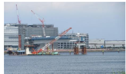
羽田国際線ターミナルとキングスカイフロントをつなぐ橋、建設中の羽田連絡道路
